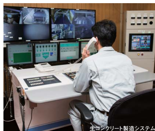
生コンクリート製造システム
